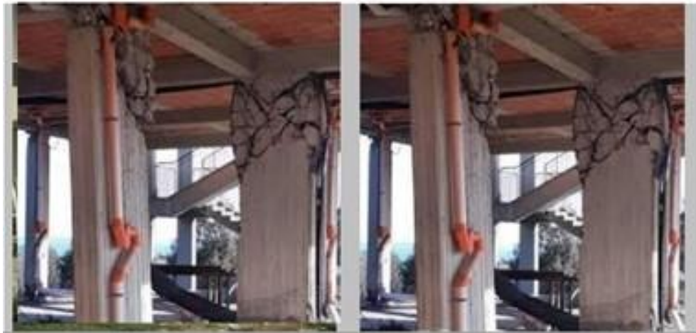
Figura 6 - Fissura causada por compressão.
