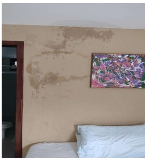
Figura 08 Infiltração no quarto.
