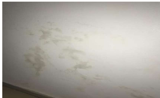
Figura 03 - Ação de capilaridade em uma edificação.
