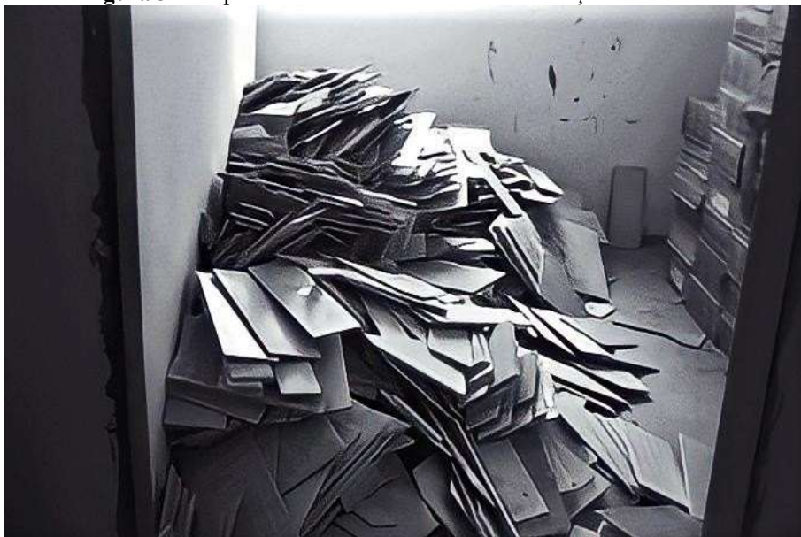
Figura 3 - Desperdício de cerâmicas devido a execução de arremates
