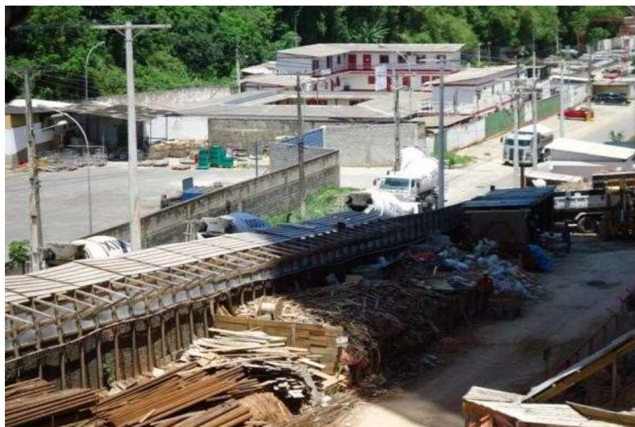
Figura 5 - Ocupação de via pública devido à má organização do canteiro
