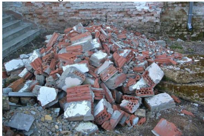
Figura 2 - Entulho de obra
